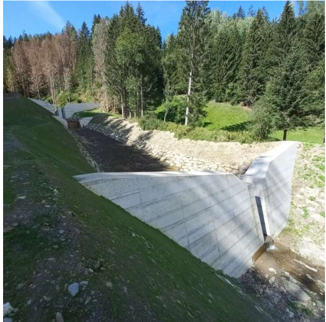
Abbildung 1: Rückhaltebauwerke am Lahmbach
